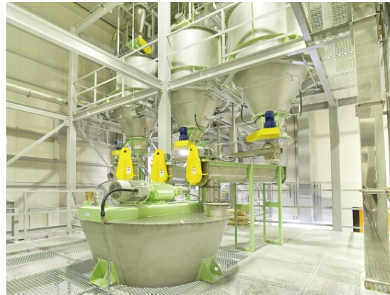
新潟工場内製粉設備
