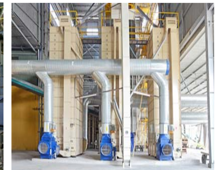
乾燥・粳摺り工場乾燥ライン
