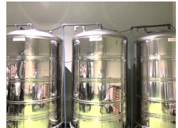
真粒米製造設備（RO水）
